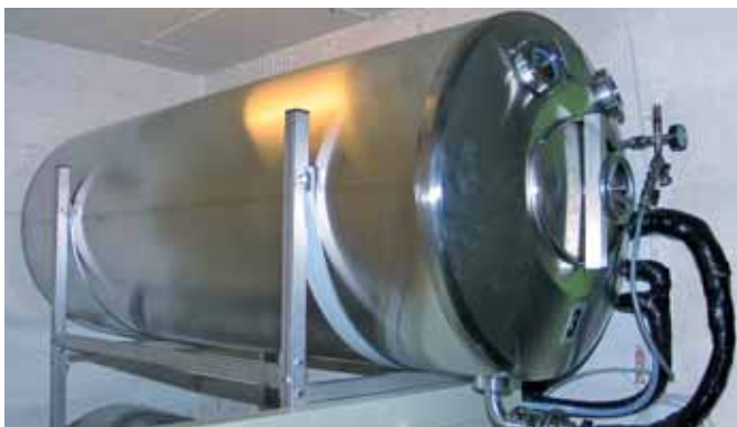
Einer der drei neuen Tanks im Keller...
